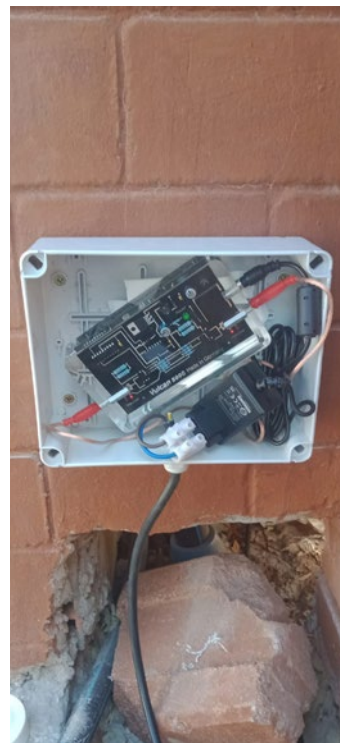
Vulcan 5000 a été installé dans un boîtier de protection
