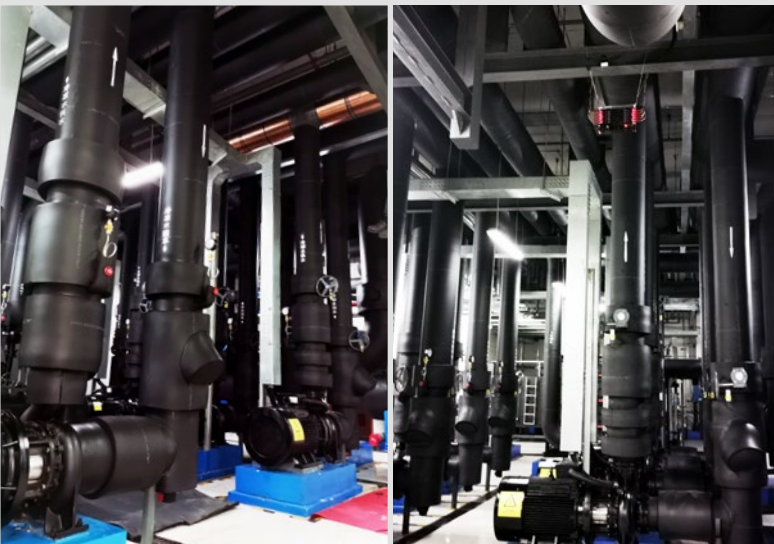
Vulcan S500 dans le bâtiment A
